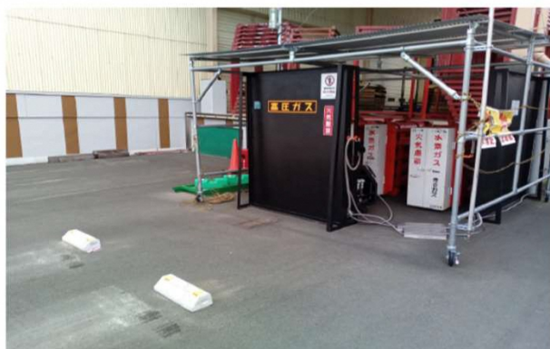
移動式水素ステーション停車前
