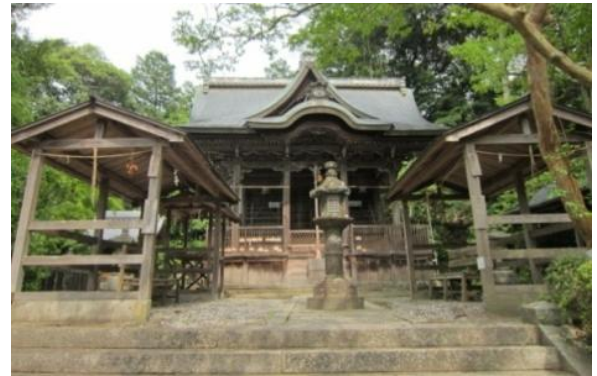
與能神社・本殿（亀岡市） 府登録文化財・本殿 の屋根修理
