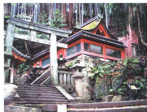
写真5 石清水八幡宮・石清水社（八幡市） 府指定文化財・石清水社 瑞籬の屋根瓦修理
