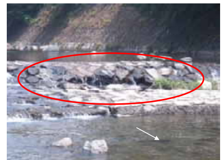
損傷している落差工（高野川）
