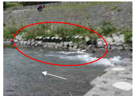
損傷している護岸（鴨川）
