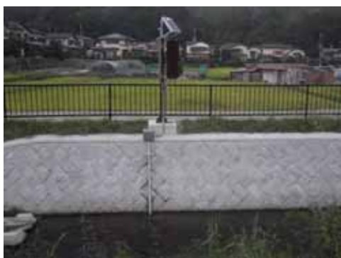
水位計の設置事例（長代川）
