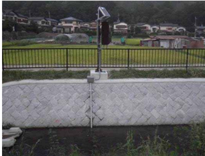
水位計の設置事例（長代川）
