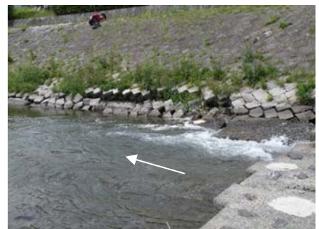
損傷している護岸（鴨川）
