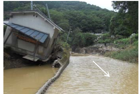
志津川の被災状況
