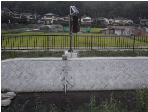
水位計の設置事例（長代川）
