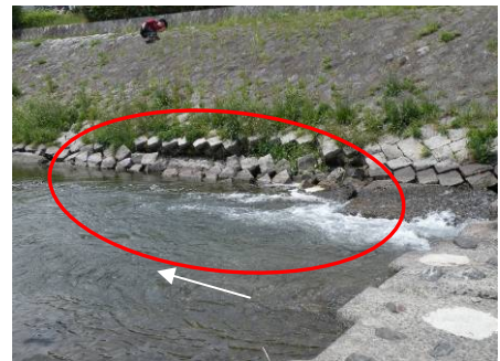
損傷している護岸（鴨川）
