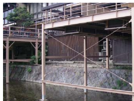
独自に室外機対策が施工されている事例
