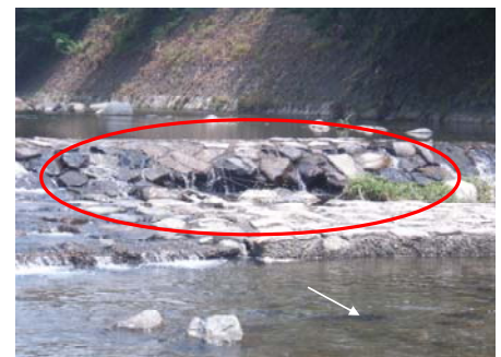
損傷している落差工（高野川）
