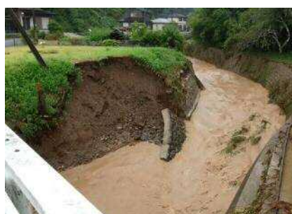
宇谷川 (舞鶴市桑飼上) 護岸一部損壊 延長10m
