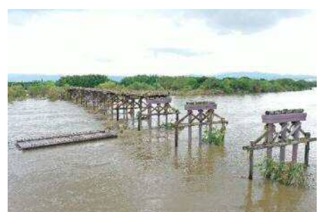
(府) 八幡城陽線 通称「流れ橋」 八幡市上津屋宮前川端 橋梁損傷 延長356m
