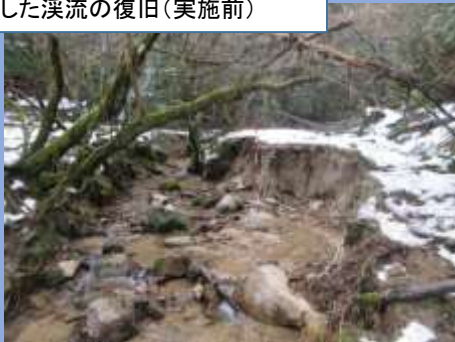
荒廃した溪流の復旧(実施前)
