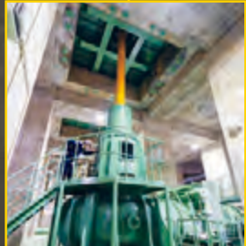
毎秒10㎡の雨水を排水するためのポンプ
