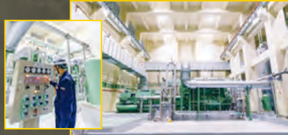
呑龍ポンプ場の心臓部である原動機室
