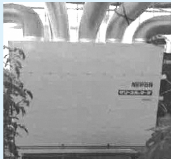
ヒートポンプ
