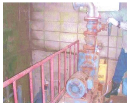
老朽化したポンプ
