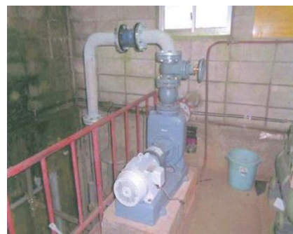
更新したポンプ
