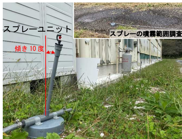
スプレーユニット (10度傾け鶏舎周囲に4m間隔で設置)
