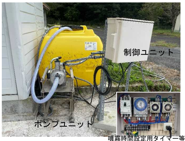
制御ユニット及びポンプユニット (タイマー制御)
