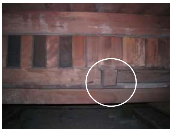
床下の雑壇框の痕跡
