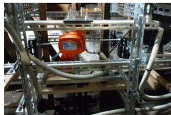
小屋裏に設置した電動昇降設備
