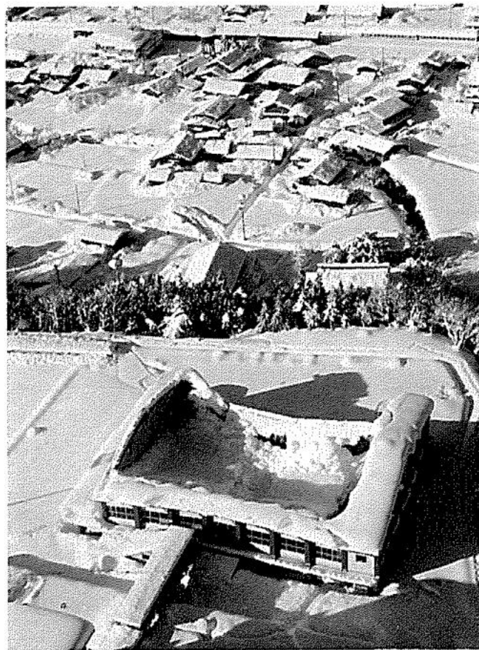
押しつぶされた屋内体育館 (白鳥町)
