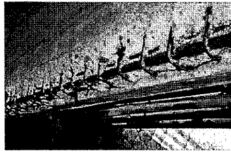
塩害により鉄筋がむき出した橋梁
