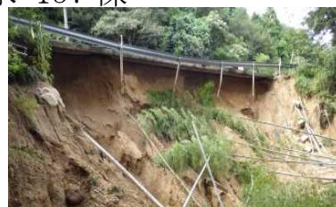
道路法面倒壊(国道 176 号(与謝野町))
