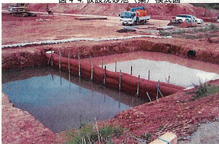
仮設沈砂池（他事例）
