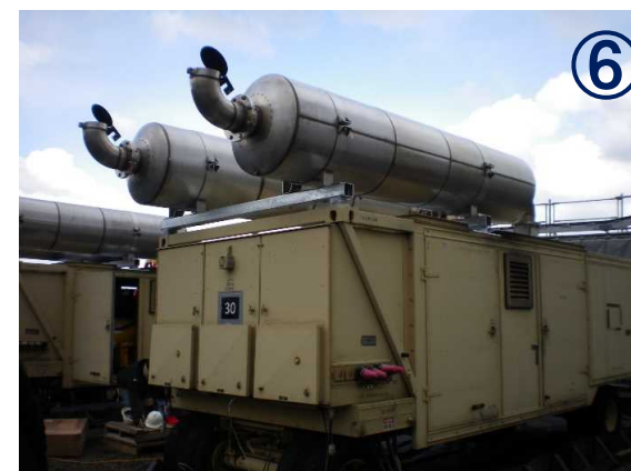
発電機マフラー
