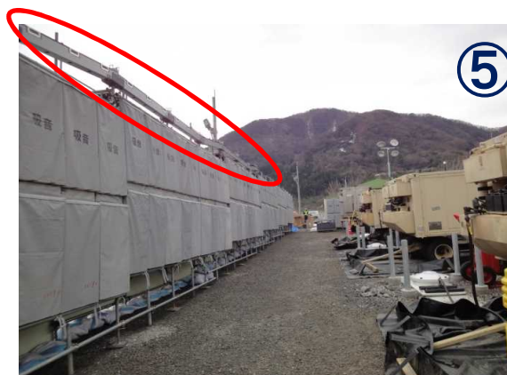
減音装置(③上部) (26. 12. 24設置)
