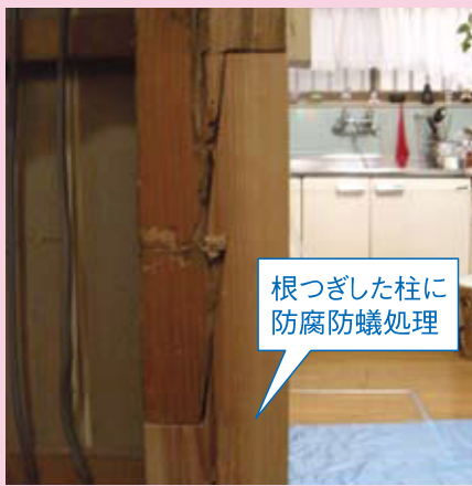
シロアリ被害を受けた柱
